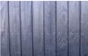
Entre 3 et 7 ans après installation
