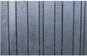
Entre 3 et 7 ans après installation
