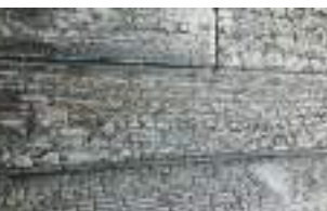
Entre 3 et 7 ans après installation
