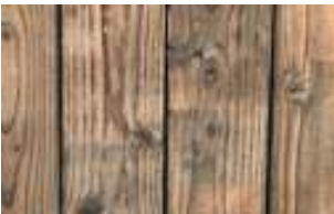
Entre 2 et 5 ans après installation
